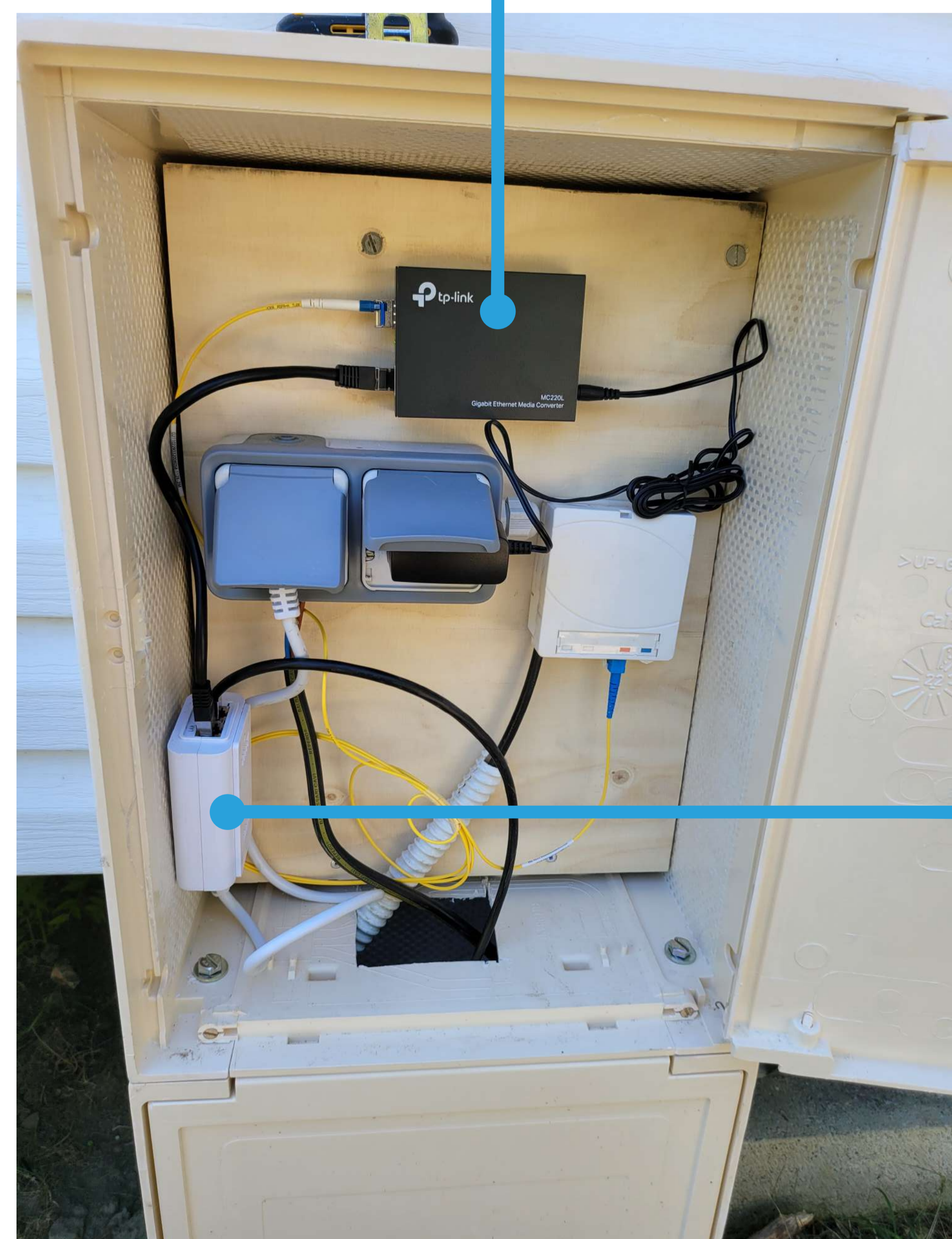
COFFRET AU SOL
